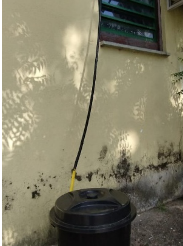
Figura 1 – Reservatório da água residual de um aparelho de ar condicionado
